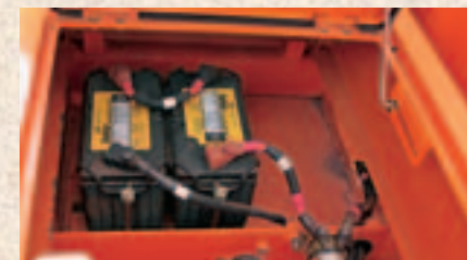
Аккумуляторы в отсеке справа от стрелы
